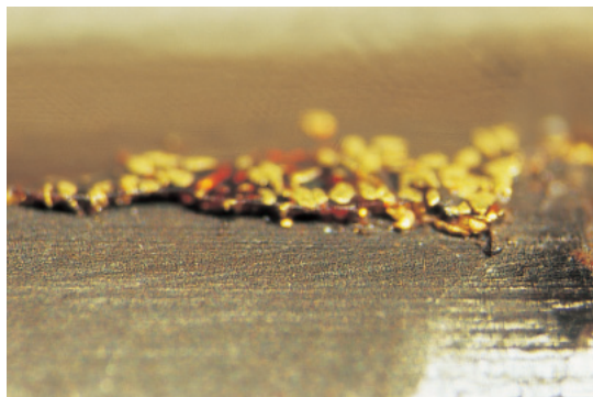
挿図5 塗膜の剥落箇所(×20)
